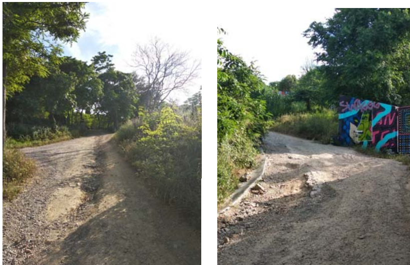
Imatges de l'estat actual del camí del camp de futbol
